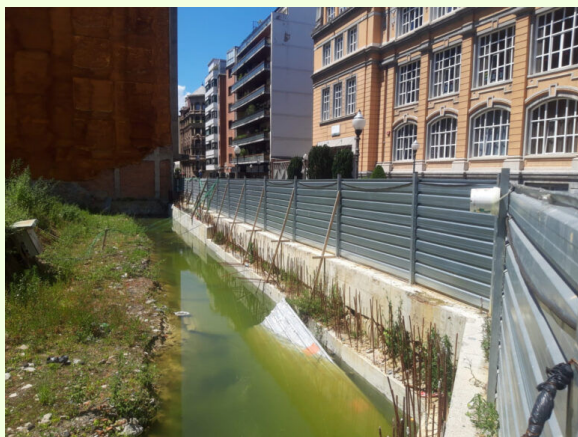
Las aguas estancadas en mayo 2026.
