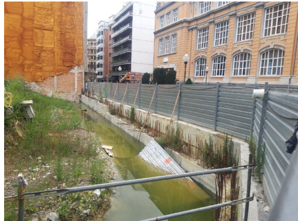
Las aguas estancadas no se han retirado en julio.
