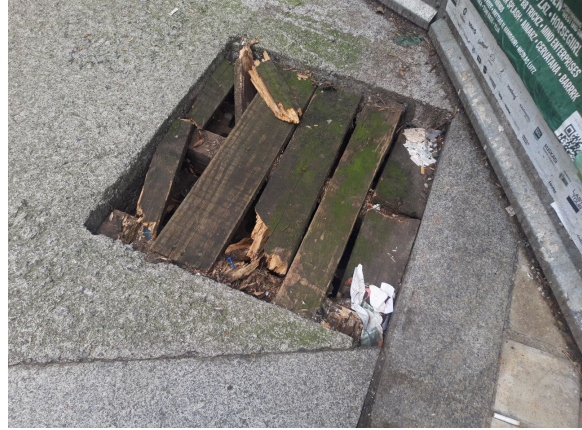
Las tablas de la tapa de la alcantarilla se han roto definitivamente en julio 2026.
