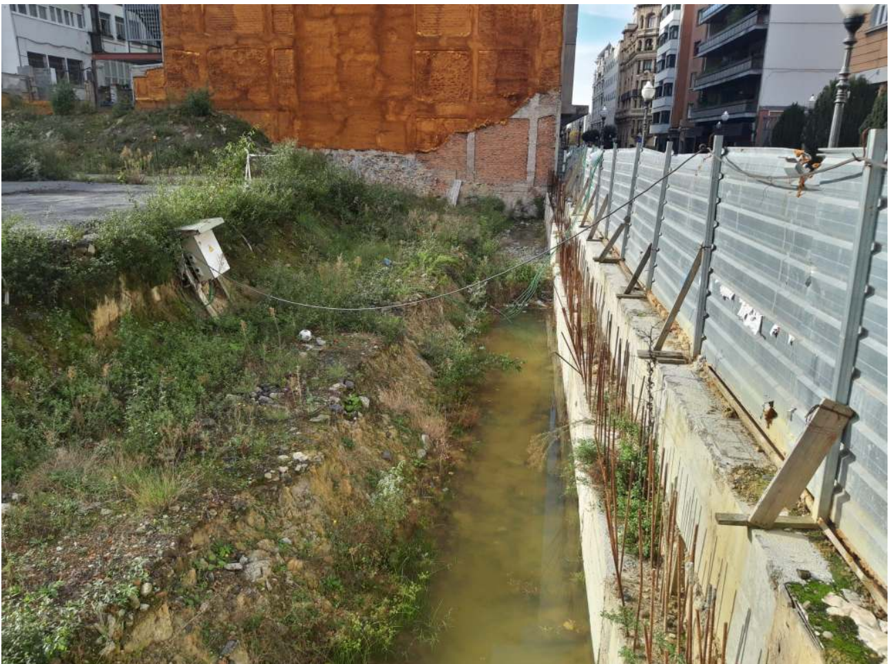
Figura 1: Apeos de madera que son insuficientes para mantener la estabilidad de la valla.
