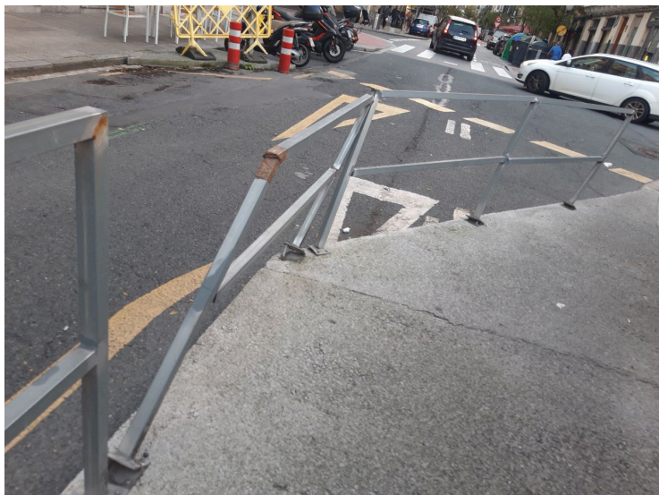
Perspectiva de la barandilla rota desde la extensión de la acera.
