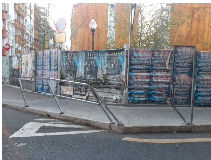
Barandilla caída en el cruce de la calle Heros con la calle Barrainkua.
