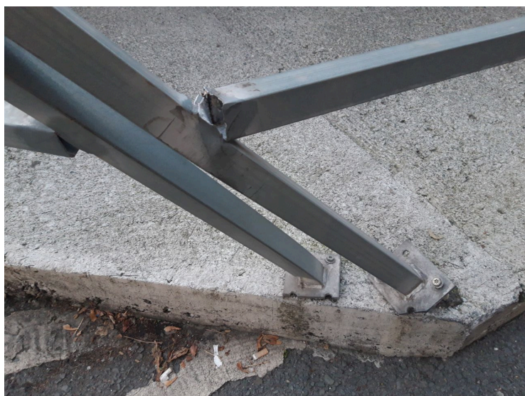
Barandilla con bordes cortantes.
