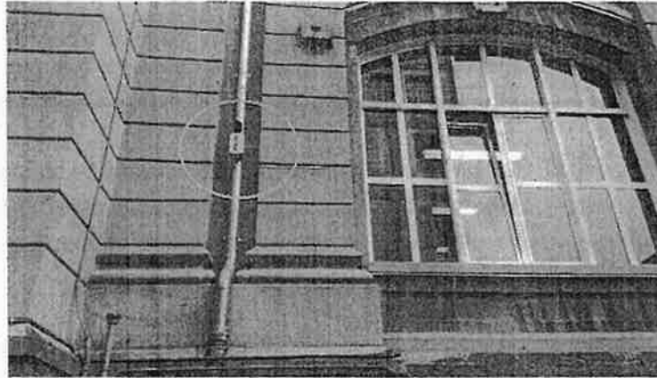
Imagen 2. Imagen del sensor TA-120 instalado en la Fachada del Colegio Público Cervantes.
